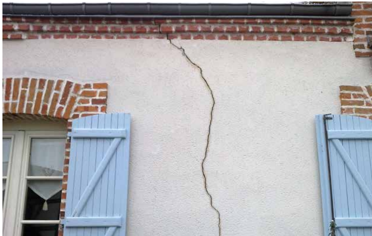
La commune été reconnue en état de catastrophe naturelle pour des mouvements de terrain allant du 1 er octobre au 31 décembre 2018.
