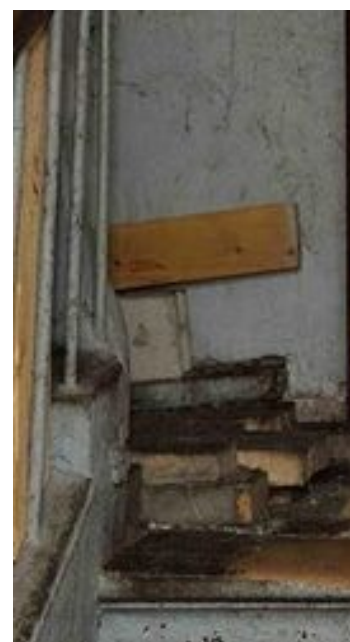
Immeubles menaçant de ruine
